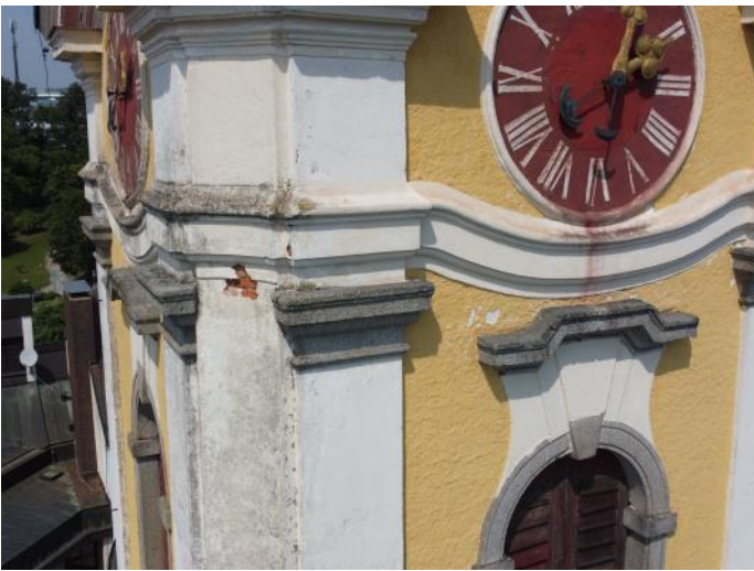
Foto: Am Glockenturm bröckelt der Putz, das Ziffernblatt der Turmuhr verliert Farbe. Auch die Zeiger sind alt und brüchig.
